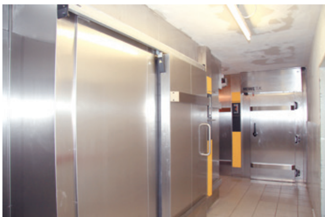
Les installations de réfrigération modernes MIWE sont aménagées dans un espace étroit, une ancienne grange.
