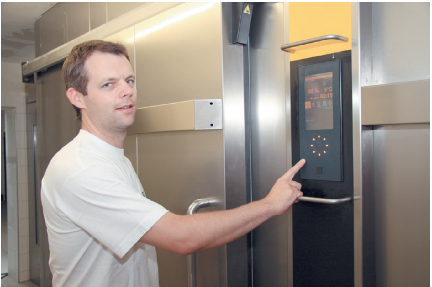
Jörg Winkler vor dem GVA mit der neuen TC-Steuerung.
