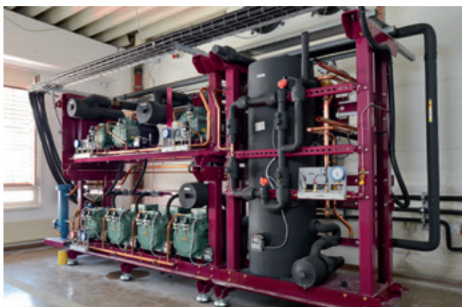
Les composants techniques du système frigorifique, bien « rangés » dans leur structure, se trouvent dans une pièce distincte.
