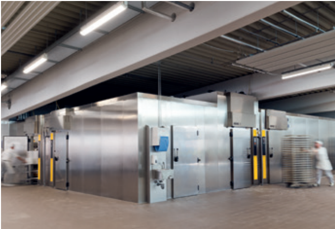
Die Hauptanlage ist ein großer Block mit Kühlzellen (links), einem Schockfroster (mitte) und einem großen Tiefkühlager (rechts).
