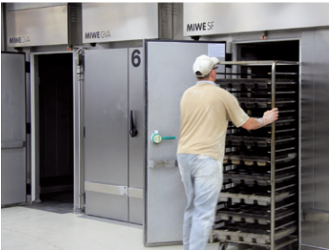
Die Schockfroster sind an einer eigenen Kältemaschine angeschlossen, um schnell die gewünscht große Kälteleistung bereitstellen zu können.
