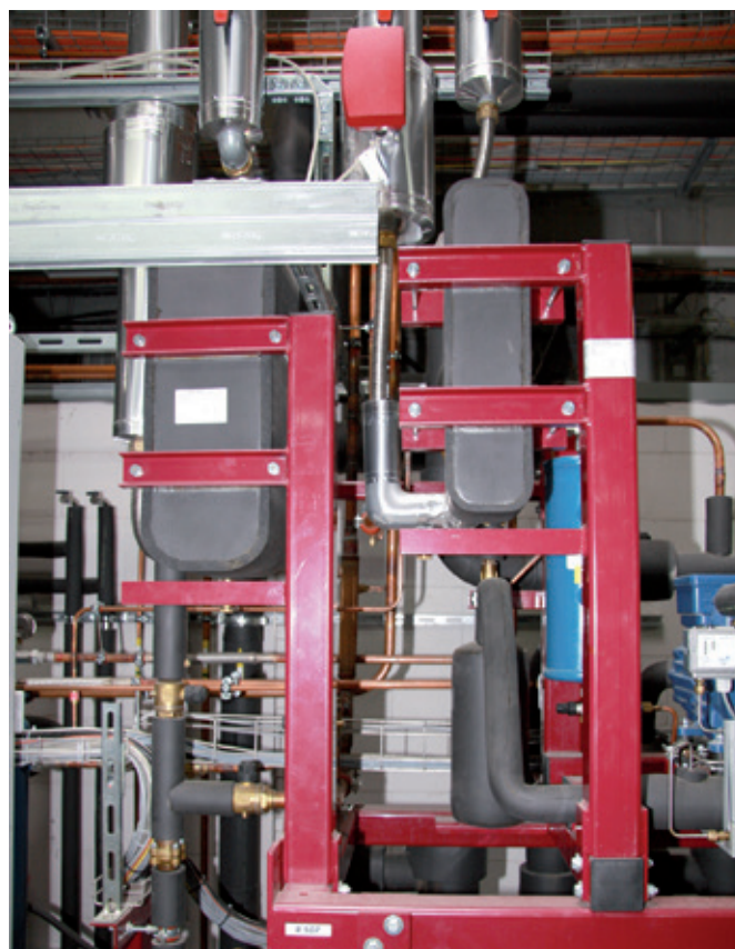
Vue de détail de l'installation de réfrigération et des échangeurs thermiques à plaques.
