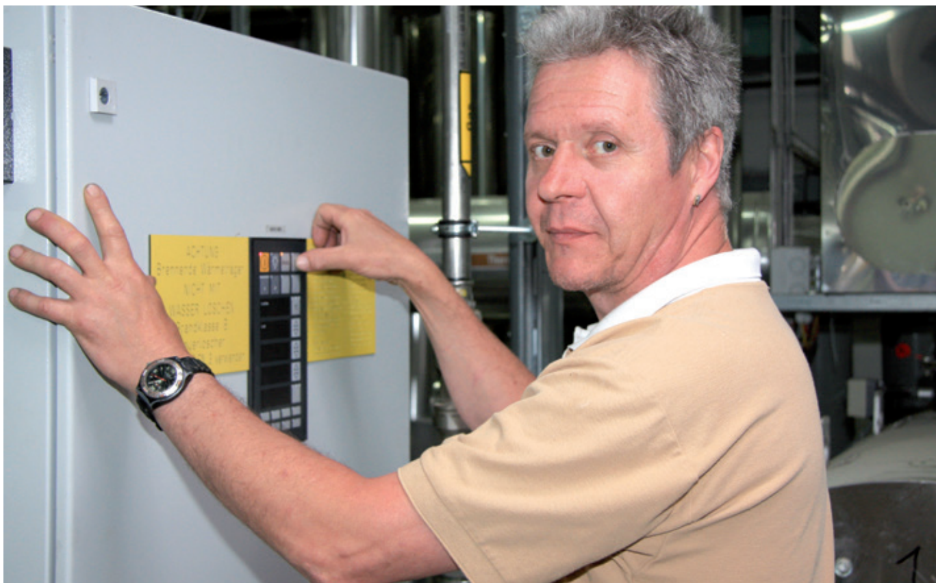
Grâce à MIWE remote, Harald Greißl, responsable des installations techniques, garde toujours une vue d'ensemble sur la technique de réfrigération.
