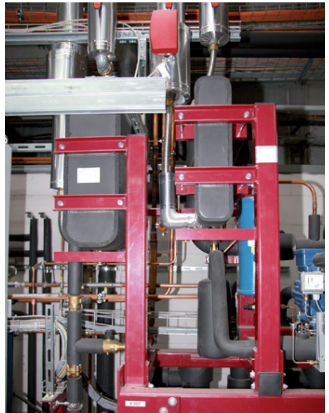
Detailansicht der Kälteanlage mit den Plattenwärmetauschern.
