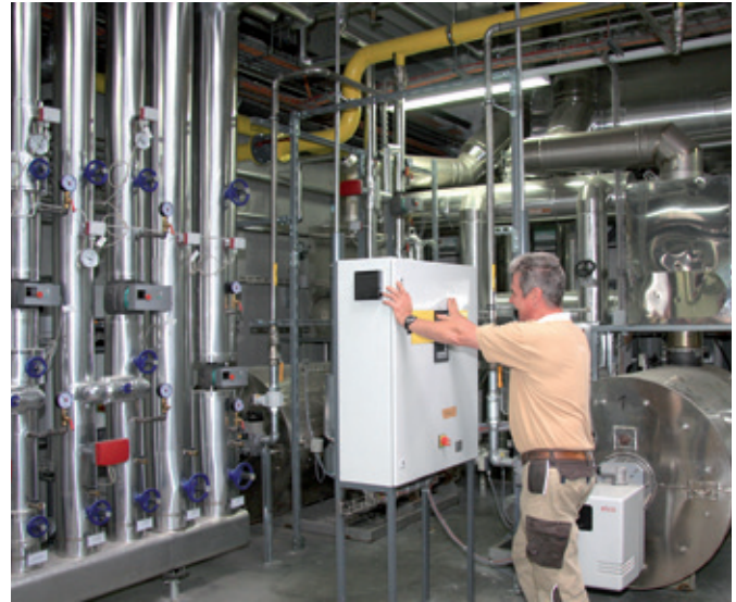
Zurück gewonnene Wärme aus Backöfen und Kälteanlagen wird der Warmwasserversorgung des Gebäudes zugeführt.
