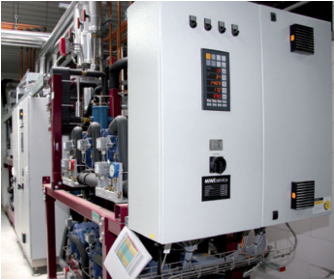
Die Kälteanlagen bei Treiber sind als Verbundanlagen konzipiert, was technisch einen gewissen Aufwand bedeutet, allerdings energetisch sinnvoll ist.
