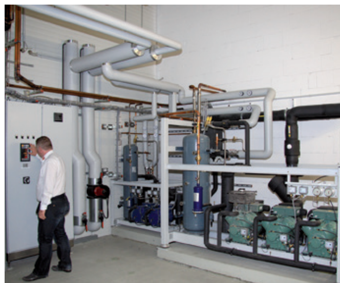
В отдельном техническом помещении размещены холодильные машины.
