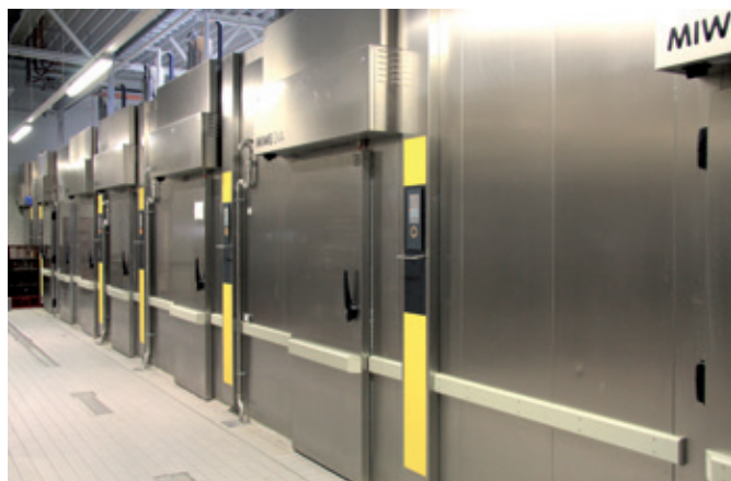
Камеры глубокой заморозки и расстойные шкафы установлены в пекарне в виде компактного блока.
