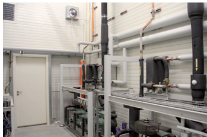
Тепло забирается от холодильных машин, пропускается через пластинчатый теплообменник и направляется в накопители для дальнейшего использования.
