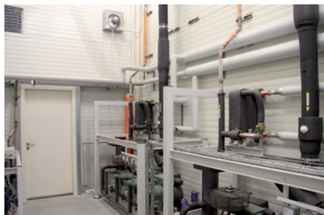
La chaleur est récupérée dans les machines frigorifique à l'aide des échangeurs de chaleur à plaques puis redirigée vers des accumulateurs de chaleur afin d'être utilisée dans différentes applications.
