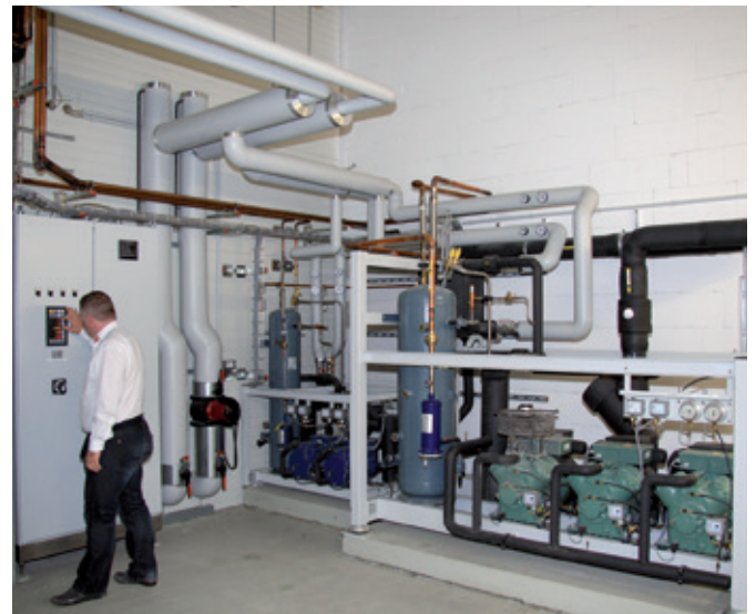
In einem separaten Technikraum sind die Kältemaschinen untergebracht.
