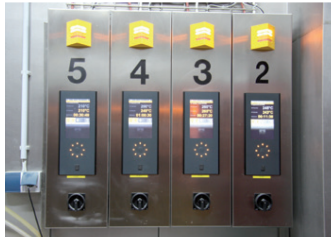
Die Steuerung der MIWE thermo-static ist separat platziert.
