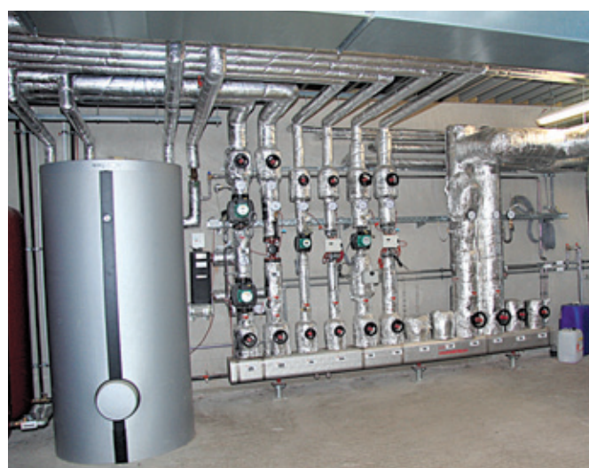
Blick in den Technikraum, wo unter anderem die Pufferspeicher platziert sind.
