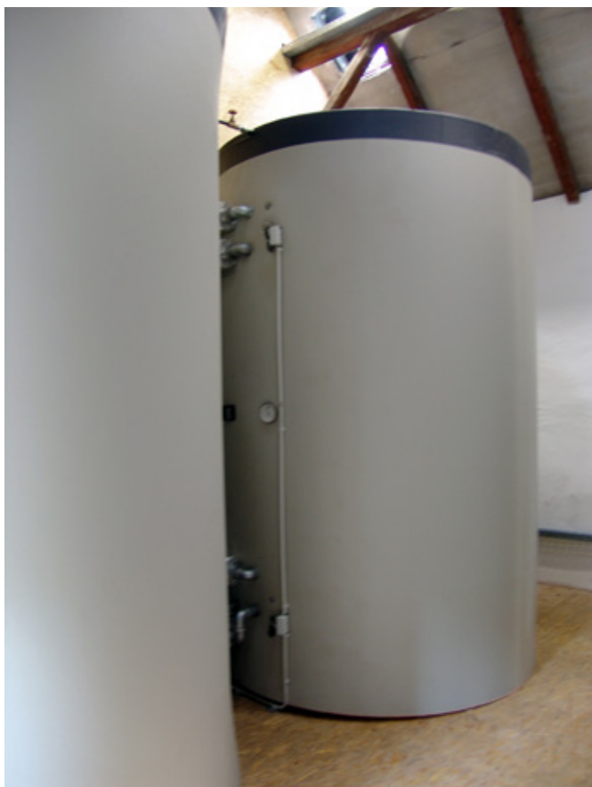
Два больших накопителя для горячей воды емкостью 13 000 литров размещены в бывшем складе муки.
