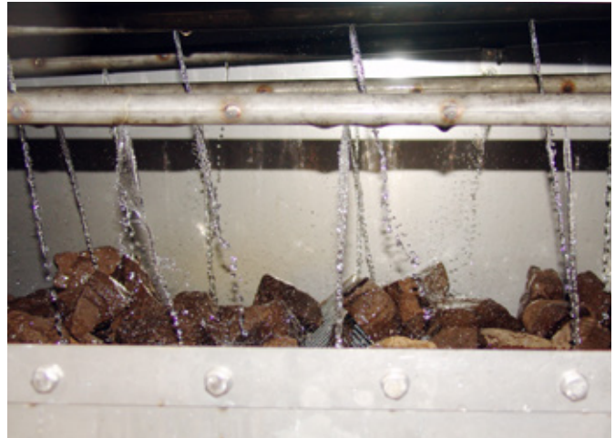
Абсорбционная очистка дымового газа в Miwe eco:nova .
