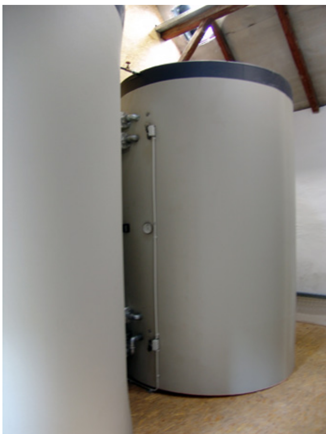
Deux grands accumulateurs de chaleur de 13 000 litres d'eau sont installés dans l'ancien grenier à farine.
