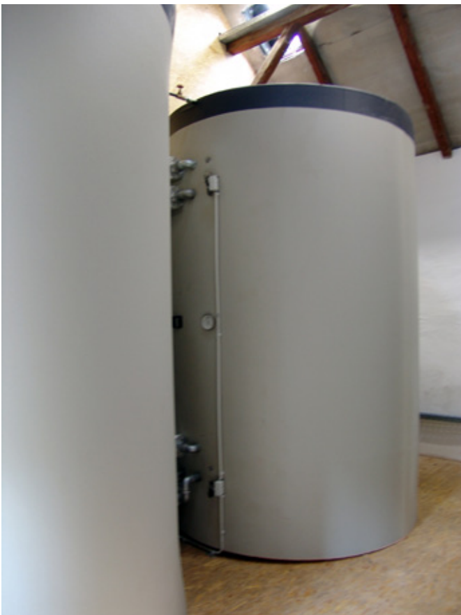
Zwei große Pufferspeicher für 13.000 Liter heißes Wasser sind im ehemaligen Mehlboden untergebracht.
