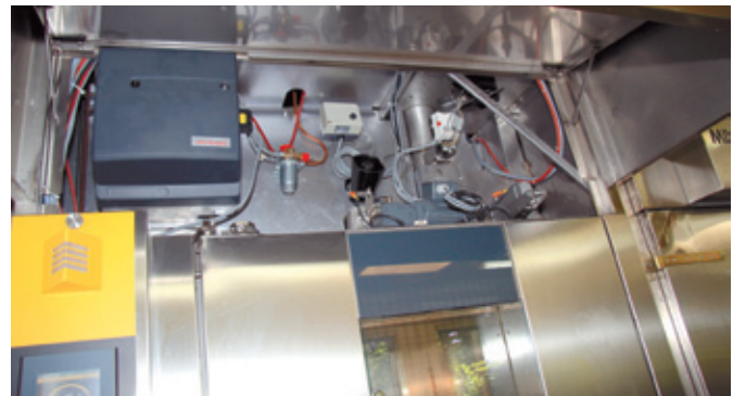
Blick in den Brenner- und Technikraum über dem Ofen.
