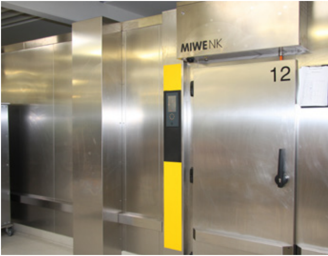
Кондитерский отдел, оборудованный системами кондиционирования, находится не в производственном цехе, а в отдельном помещении. Наряду с другими установками, здесь располагается холодильная камера для пралине.
