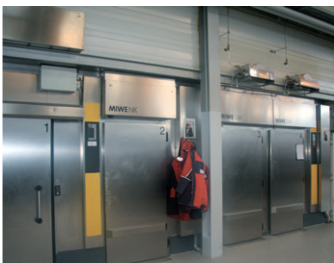
С боковой стороны производственного цеха установлены холодильные камеры шоковой заморозки и обычного охлаждения, а также автоматические расстойные шкафы.
