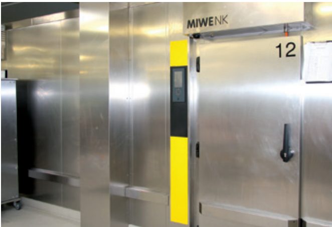
Aus der Produktionshalle ausgelagert ist die klimatisierte Konditorei. Hier ist unter anderem der Pralinenkühlraum platziert.
