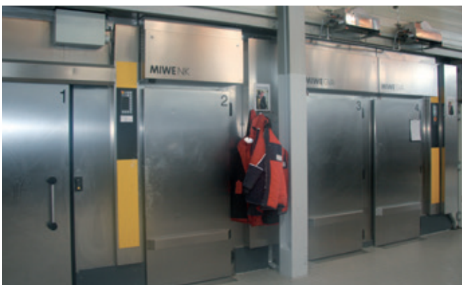
Seitlich an die Produktionshalle angedockt sind die Kältezellen mit Schockfroster, Normalkühlung und Gärvollautomaten.
