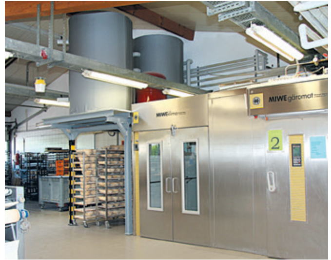
Les réservoirs de stockage sont posés sur une estrade. Comme ça, on ne perd pas de place dans l'atelier de boulangerie.
