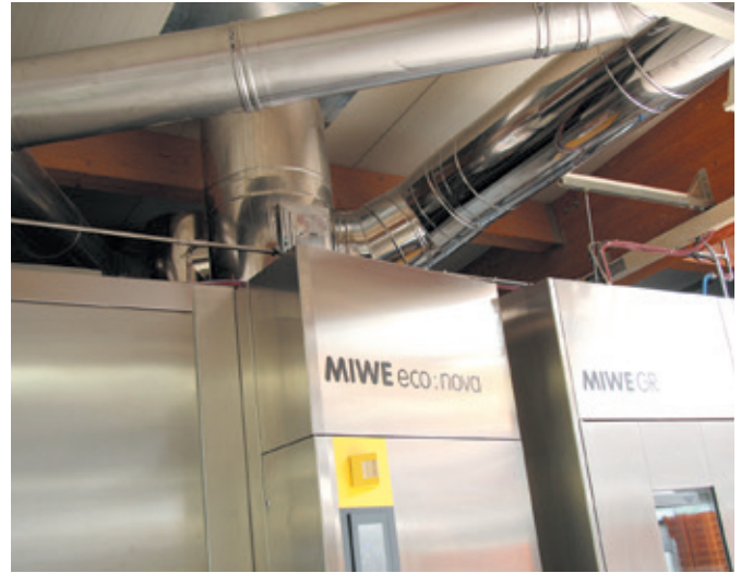
Détail de l'éco : nova : il y a une conduite de gaz de fumées et une conduite de buée provenant des fours.
