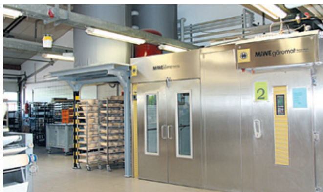
Die Pufferspeicher wurden auf ein Podest platziert. So ging kein Platz in der Backstube verloren.
