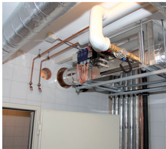
В подсобном помещении дымоотводы обеих стеллажных печей подведены к MIWE eco : box.
