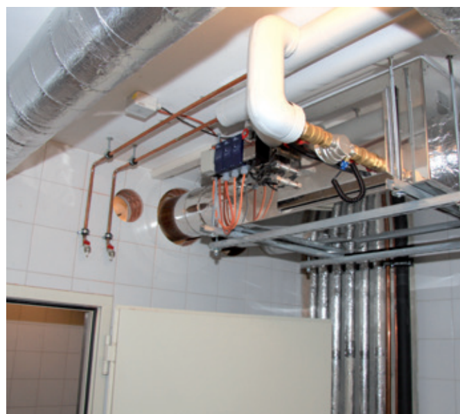
Dans une pièce annexe, les conduites d'évacuation des deux fours à chariot rotatif sont raccordées à la MIWE eco:box.
