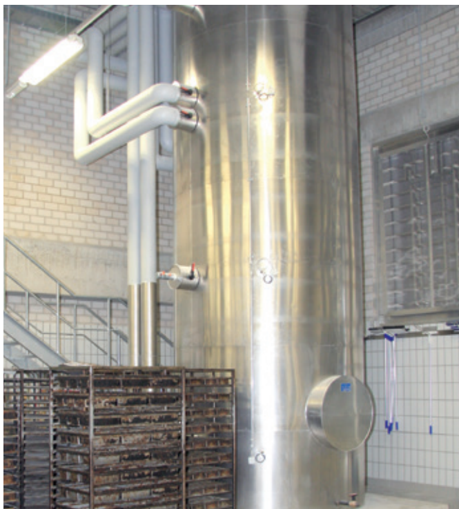
L'accumulateur de chaleur à plusieurs couches a une contenance de 30 000 litres. Il stocke l'énergie récupérée et la redistribue selon les besoins.
