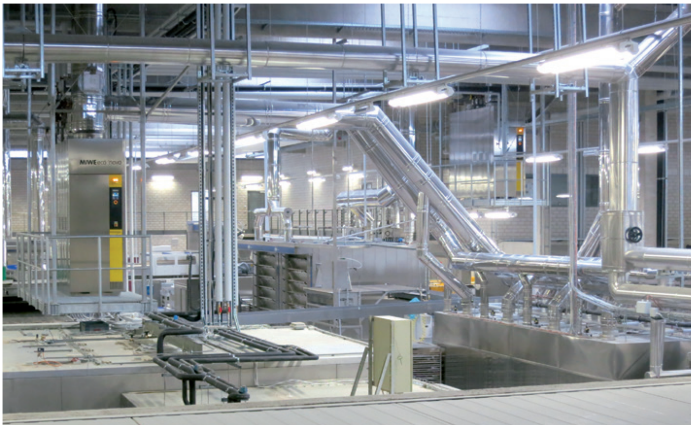
Le surplus d'énergie des fours à chariot fixe et fours à chariot rotatif est dirigé vers la MIWE eco : nova installée au-dessus d'une cellule de réfrigération. Cela permet de réduire la longueur des tuyaux et d'économiser de la place.
