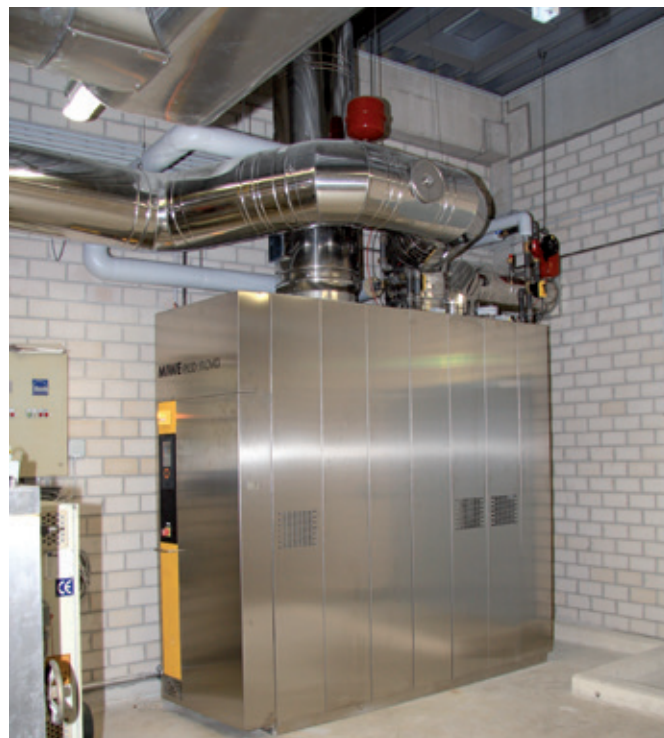
Une MIWE eco:nova fonctionne grâce aux gaz de fumée de la chaudière de chauffage central pour les fours à huile thermique. Elle est installée à côté de la chaudière de chauffage central.
