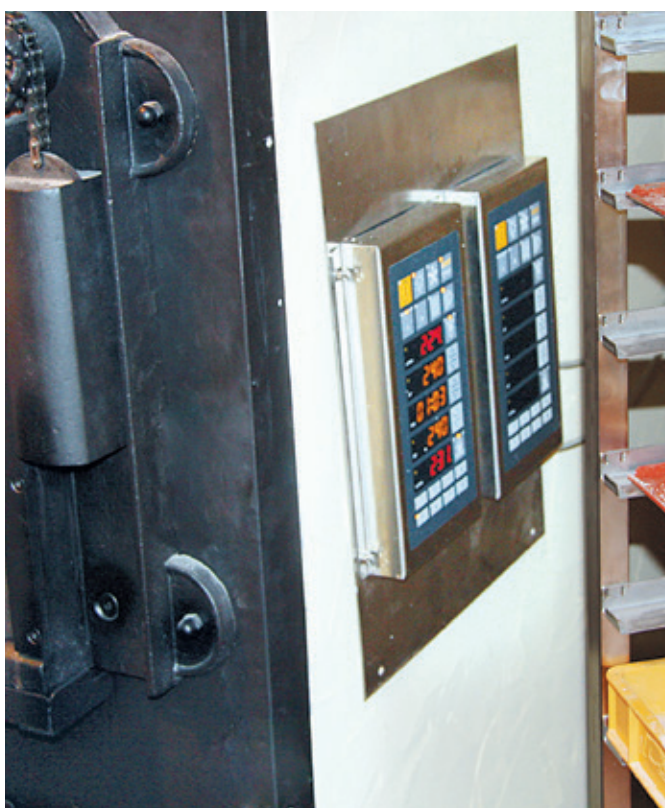
La commande pour le four est placée sur le côté. Elle n'est pas visible pour les clients.
