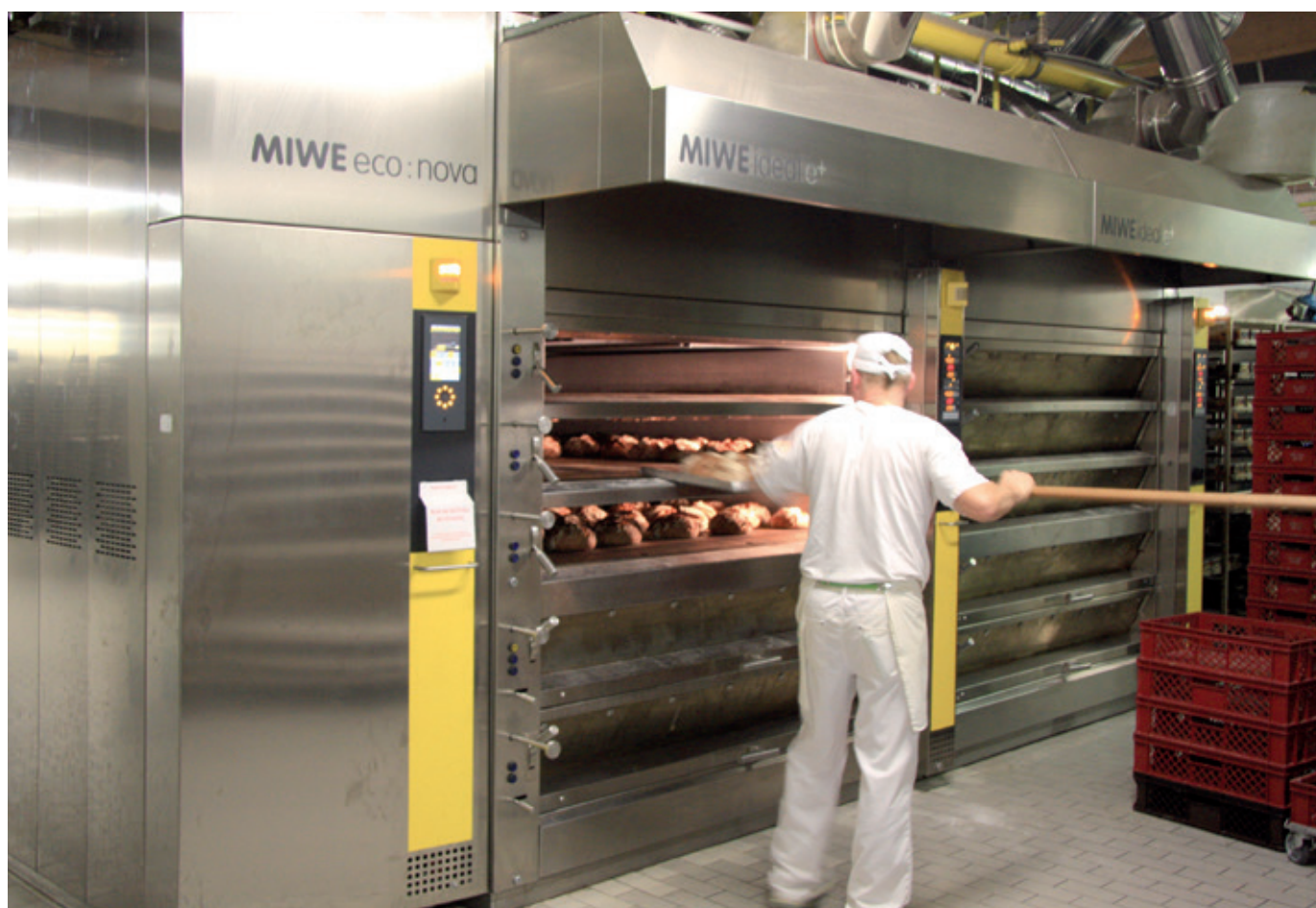
Deux fours MIWE ideal e+ sont essentiellement utilisés pour le pain. Juste à côté se trouve le MIWE eco:nova, qui est en outre alimenté par la chaleur résiduelle de la chaudière centrale de chauffe.
