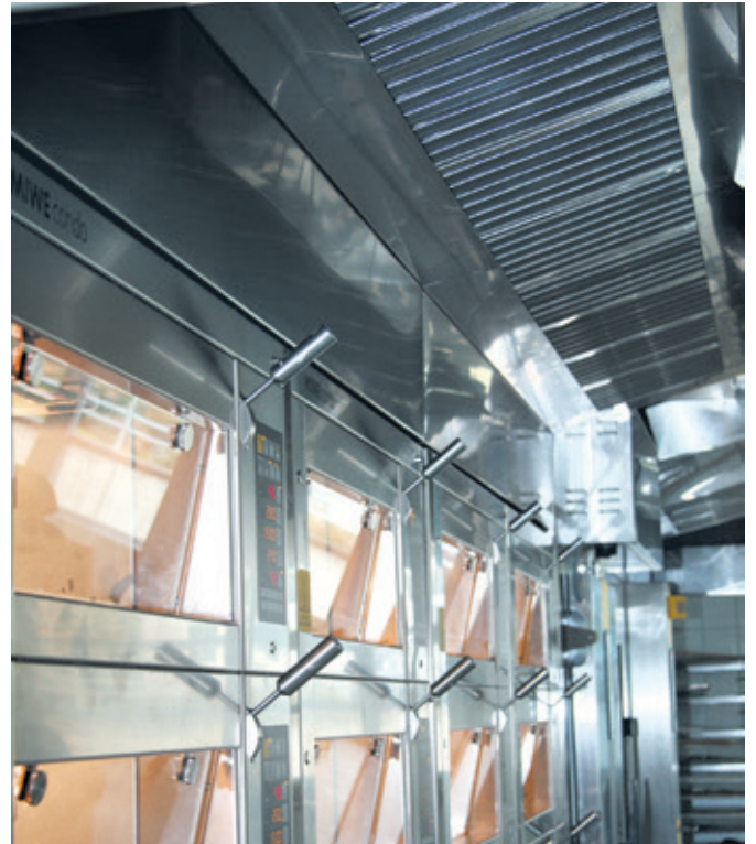
Une évacuation des buées de larges dimensions, installée au-dessus des fours, garantit un climat agréable au sein du fournil d'apprentissage.
