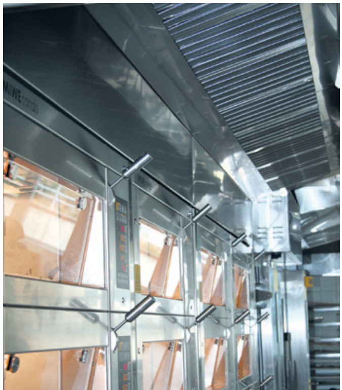
Für ein gutes Klima in den Lehrbackstuben sorgt eine großzügig dimensionierte Ablufführung über den Backöfen.
