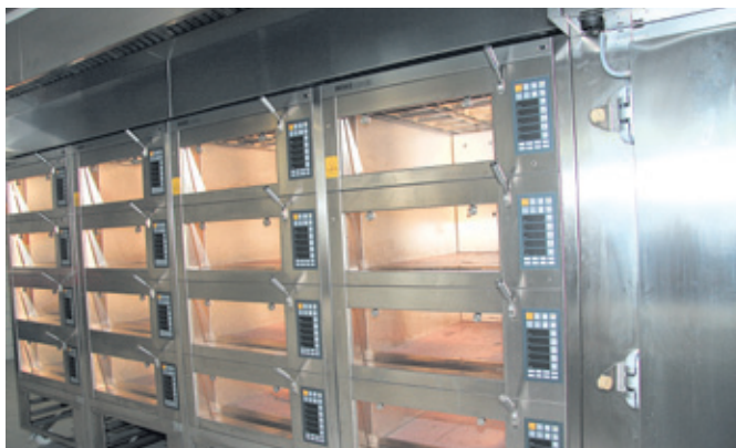
Die Steuerungen der Öfen sind vernetzt und können vom Vorbereitungsraum der Lehrkräfte aus bedient werden.
