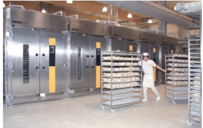
Coup d'œil sur les chambres de conditionnement et de fermentation de la boulangerie.
