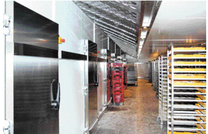
Großzügig dimensioniert ist die Kältefläche bei Gellertstadt Backwaren. Von den Lagerzellen führen Türen (links) direkt in Gärvollautomaten bzw. von den Schockzellen geht es direkt in die Lagerzellen.
