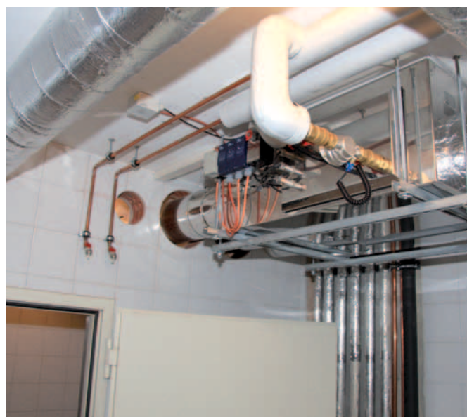
In einem Nebenraum werden die Abgasrohre der beiden Stikkenöfen in die MIWE eco:box zusammengeleitet.
