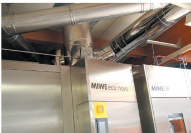
Detailansicht der eco : nova: Von den Backöfen kommt ein Rohr für Rauchgas und ein Rohr für Schwaden.
