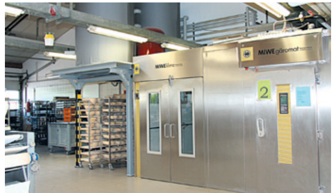
Die Pufferspeicher wurden auf ein Podest platziert. So ging kein Platz in der Backstube verloren.
