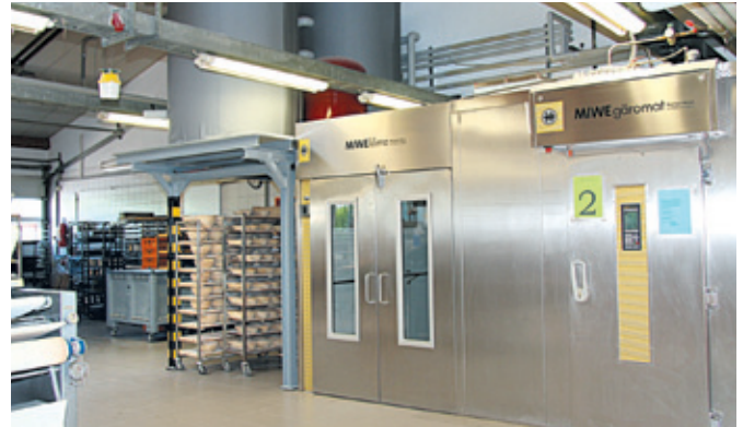
Die Pufferspeicher wurden auf ein Podest platziert. So ging kein Platz in der Backstube verloren.
