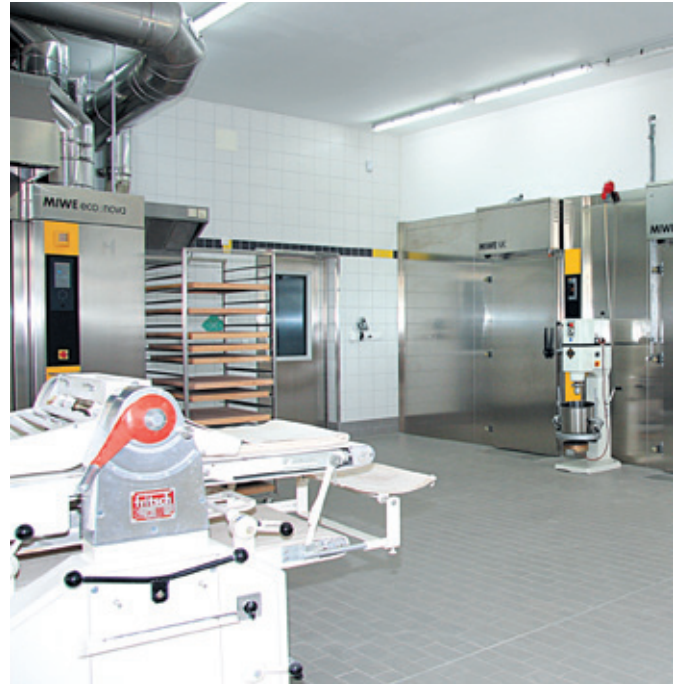
Ansicht der Kälteanlage.
