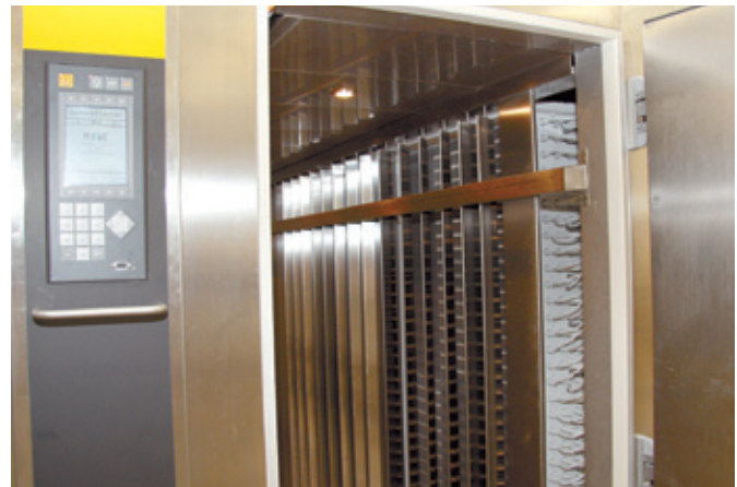
Einer der Schockfroster hat seine Verdampfer an der Seite (Bild). Der andere hat sie oben, um später eine Durchschiebeanlage einbauen zu können.
