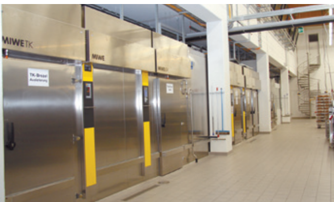
Die Kältezellen sind an der Seite der Produktion platziert.
