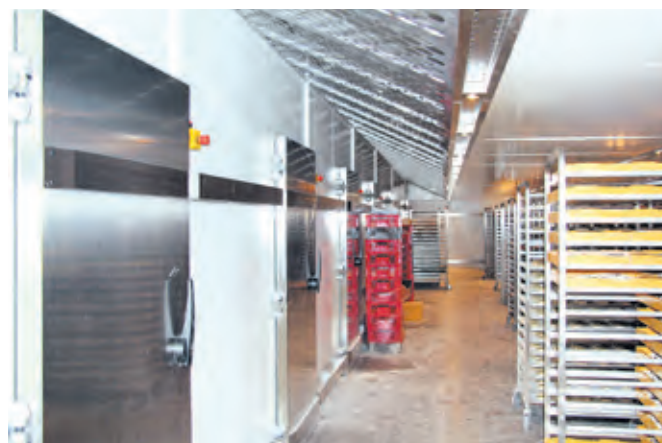
Großzügig dimensioniert ist die Kältefläche bei Gellertstadt Backwaren. Von den Lagerzellen führen Türen (links) direkt in Gärvollautomaten bzw. von den Schockzellen geht es direkt in die Lagerzellen.
