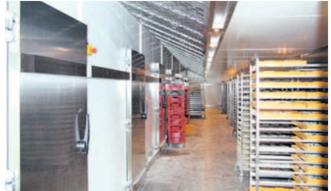
La surface de réfrigération est généreusement dimensionnée chez Gellertstadt Backwaren. A partir des cellules de stockage, les portes (à gauche) mènent directement aux installations de fermentation entièrement automatiques, ou bien elles permettent l'accès direct aux cellules de stockage à partir des cellules de surgélation rapide.
